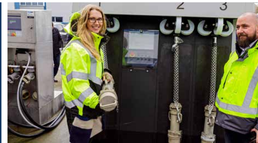
Daglig leder i Egersund Landstrøm og Kenneth Husabø fra Blueday Technology viser fram strømuttaket på kaien.
